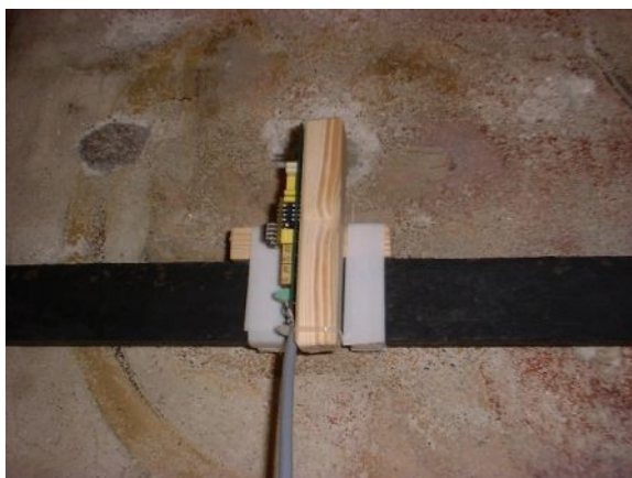
Figura 3: esempio di accelerometro fissato su tirante metallico
